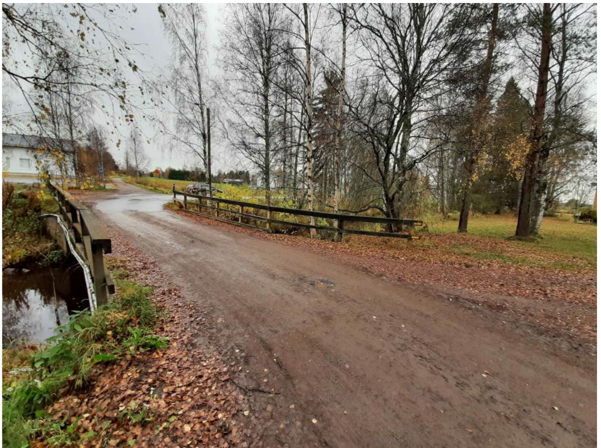
Kuva 10 Pengerkaiteet puuttuvat. Sillankaiteen jatkeet eivät anna suojaa liikenteelle.
