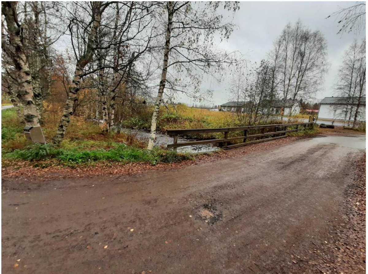
Kuva 15 Tiessä siltapaikalle on tuen 1 penkereellä yksittäisiä purkautumia ja tuen 2 penkereellä yksittäisiä syöpymiä. Pengerkaiteet puuttuvat.
