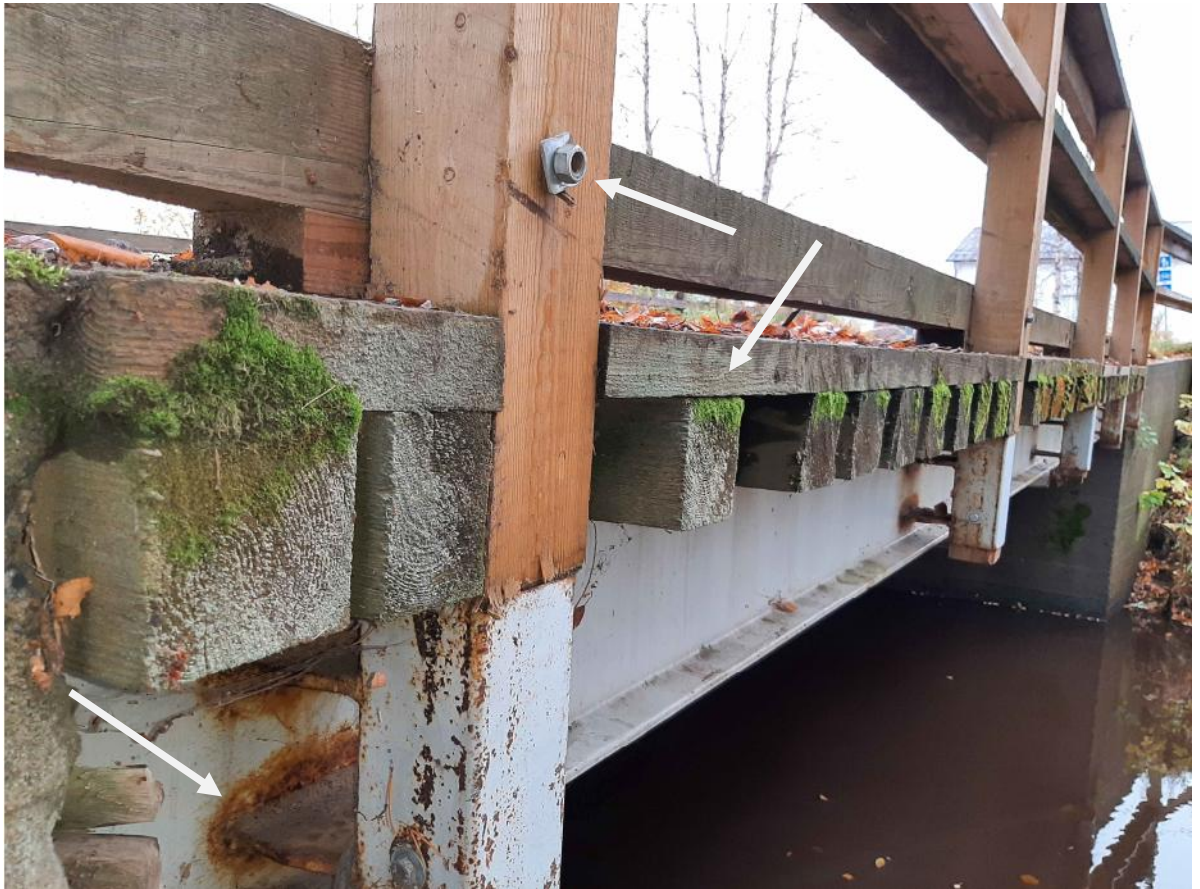
Kuva 9 Sillassa on puukaiteet, jotka kiinnittyvät täksiseen jalustaan sekä suiste- parruun. Poikkikannattajien päissä on alkava lahovaurio.
