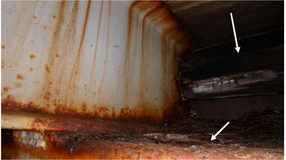
Kuva 5 Kannatinpalkin ruostevaurio laakritasolla. Alla ruostunut poikkiside. Kannatinpalkkien välinen puinen jäykiste on vakavasti lahonnut.
