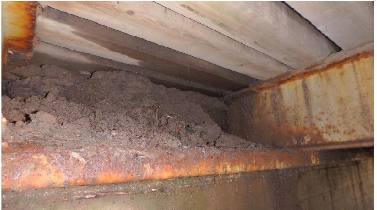
Kuva 11 Maa-ainekset valuvat kannen päästä laakeritasolle tuella 1. Palkkien välinen puinen jäykiste on lahonnut osaksi tai kokonaan pois.
