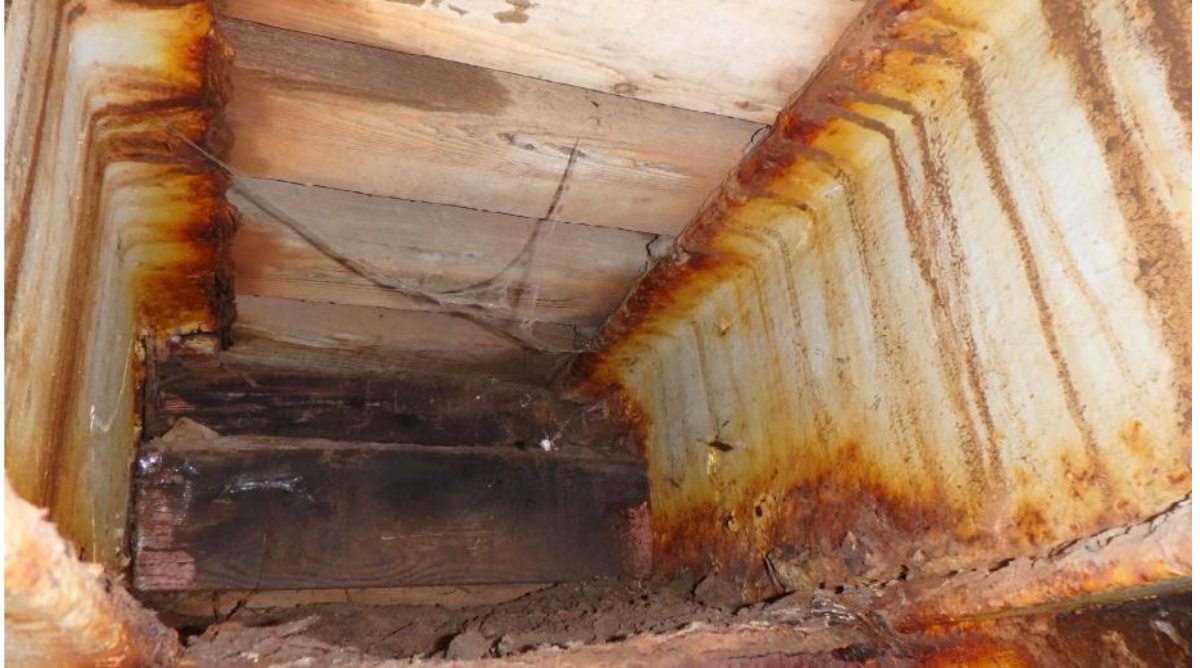
Kuva 13 Tuen 1 laakeritaso. Palkkien välinen puinen jäykiste on lahonnut.
