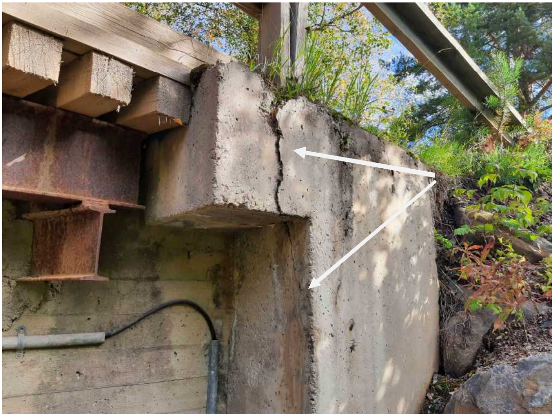
Kuva 2, Tuen 2 oikean siipimuurin konsolin halkeilu kaidepylvään kohdalta.
