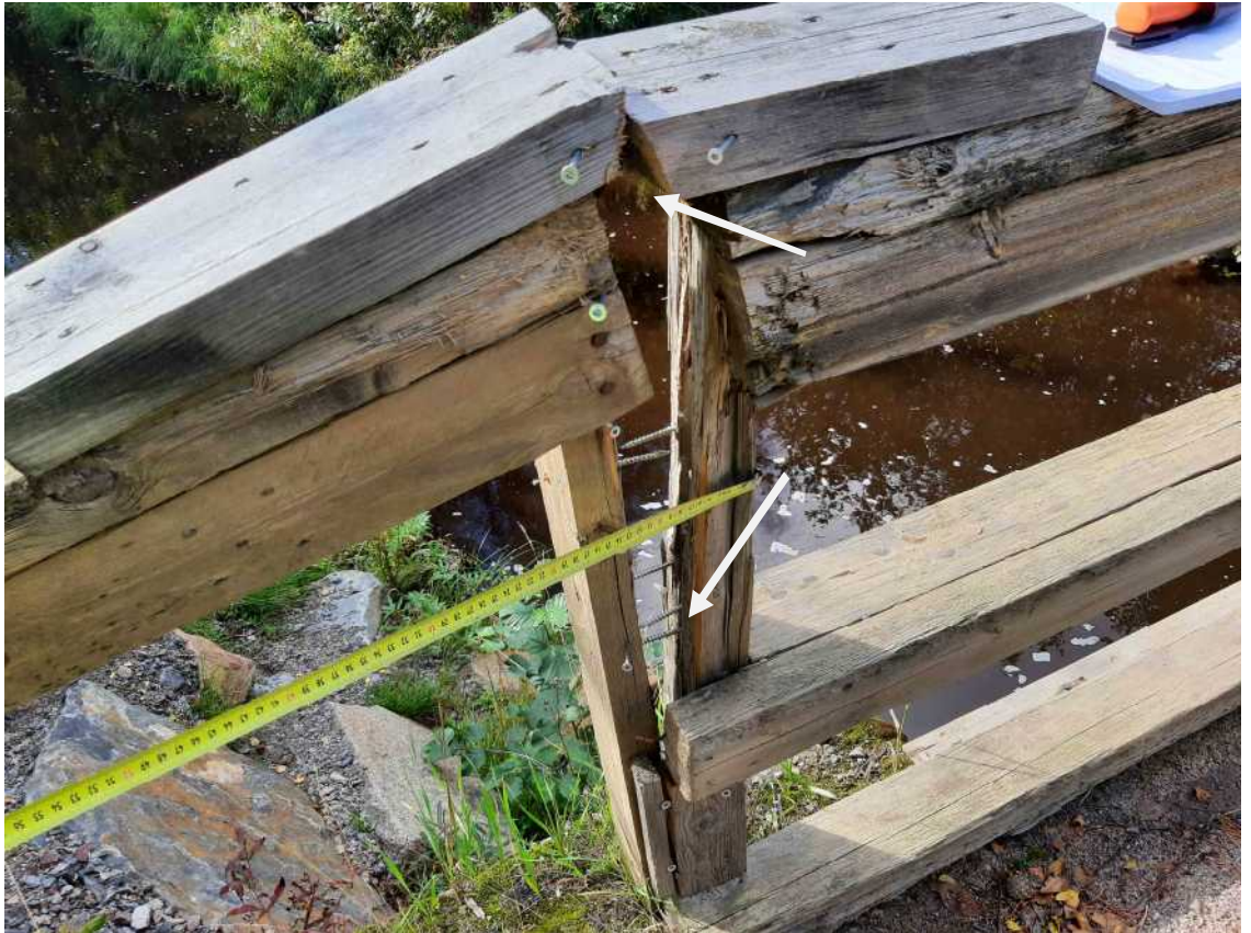
Kuva 10 Sillan kaidetolppa on haljennut kunnossapitokaluston osuessa tolppaan tuki 2 oikea.
