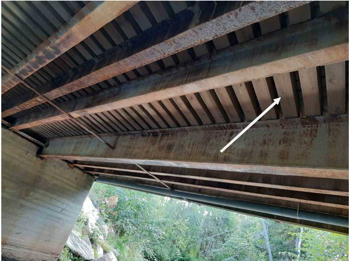
Kuva 4, Sillan puisissa poikkikannattajissa on vain yksittäisiä vaurioita.
