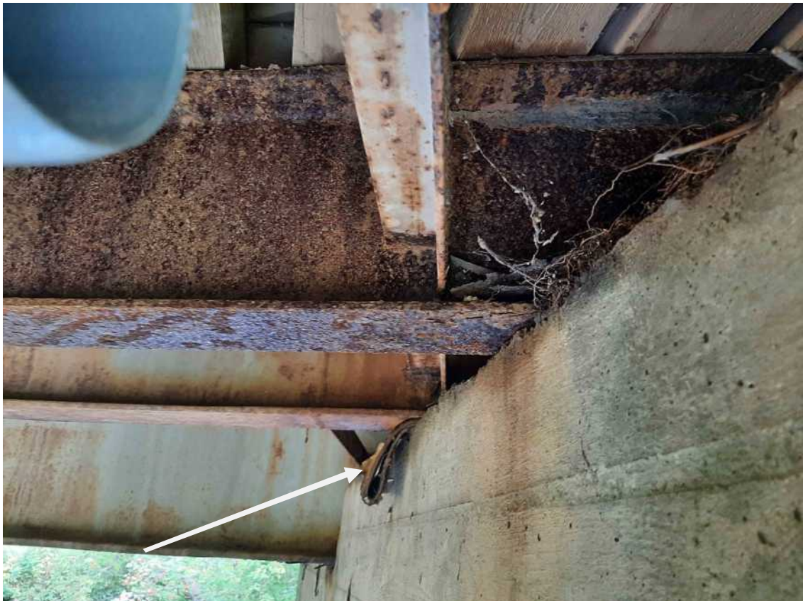
Kuva 14 Tuen 2 laakeritaso. Palken laakerilevy on työtynyt palkin alta.
