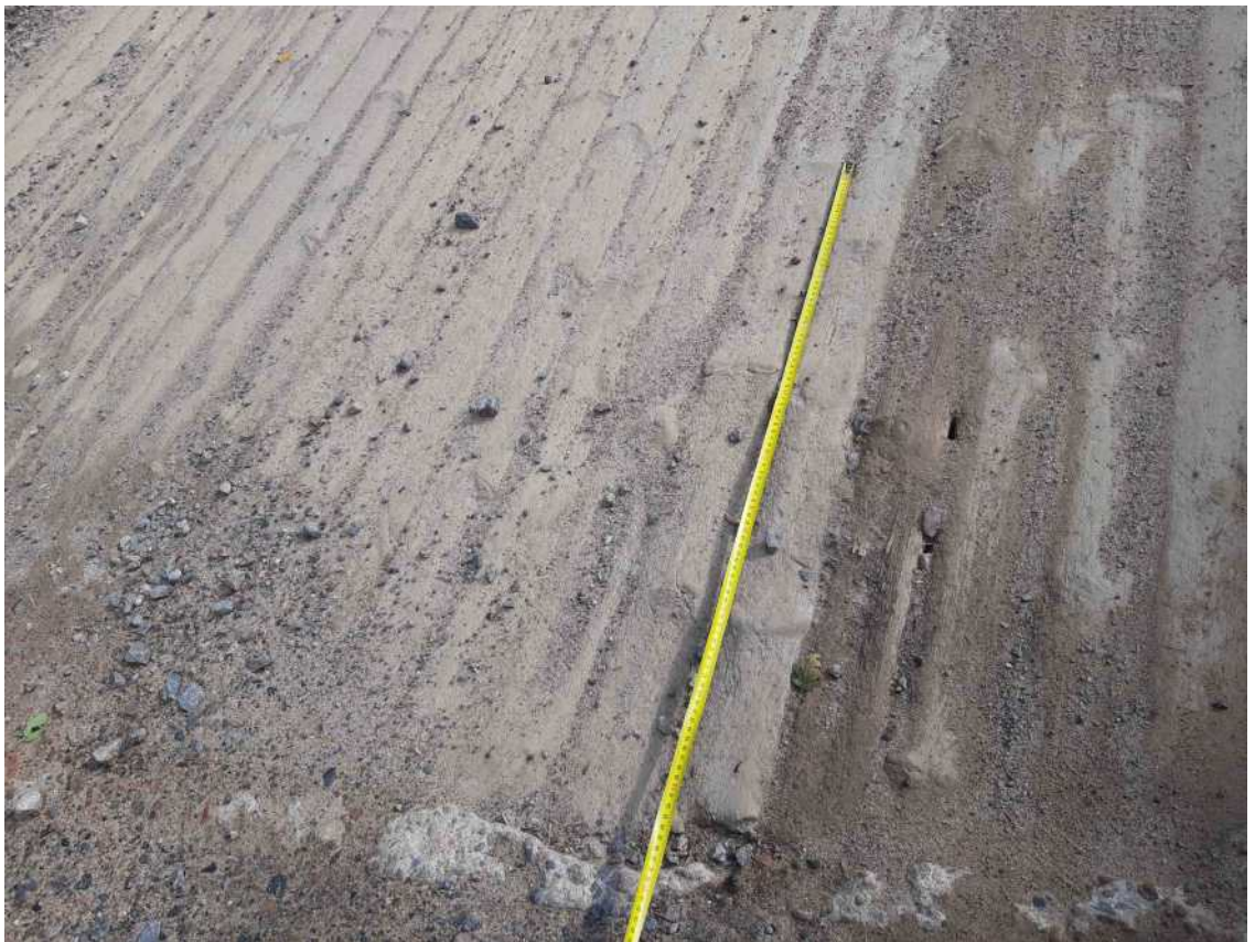
Kuva 8 Kansilankutuksessa on voimakasta kulumaa tuen 1 kannen puoleisessa päässä ~2m 2 alalla.
