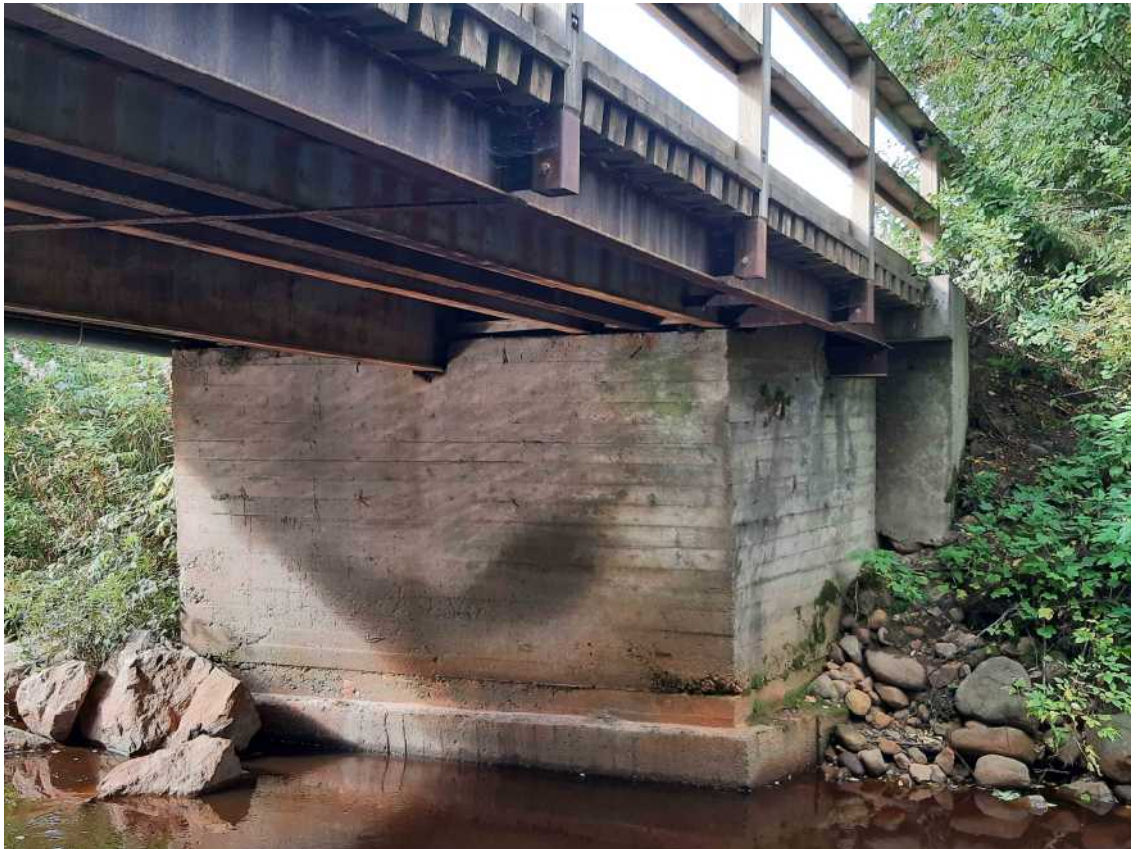
Kuva 15 Tuella 1 vasemmalla puolella on keila osittain sortunut. Siipimuurin konsolin alta puuttuu maa-aineksia tuella 1 vasemmalla- ja tuella 2 oikealla puolella. Keiloissa kasvaa vesakkoa.
