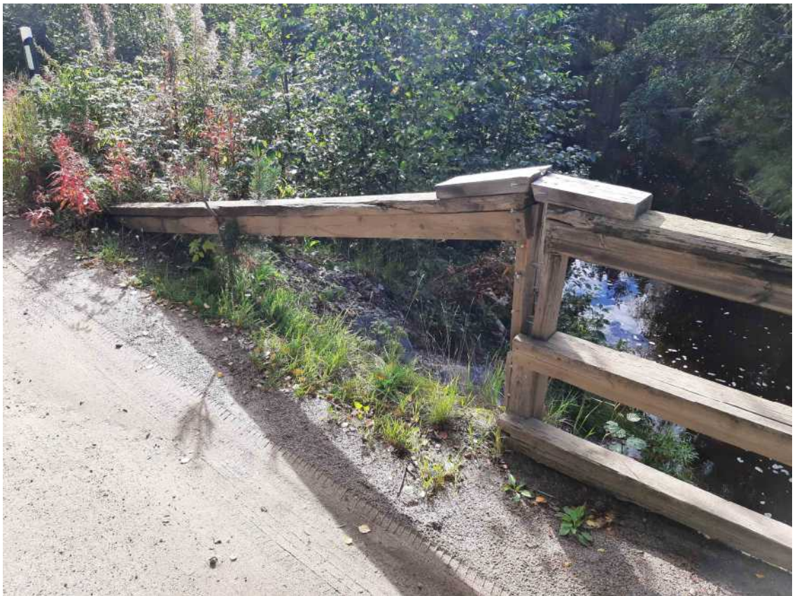
Kuva 12 Pengerkaiteet puuttuvat. Sillankaiteen jatkeet eivät anna riittävää suojaa liikenteelle.
