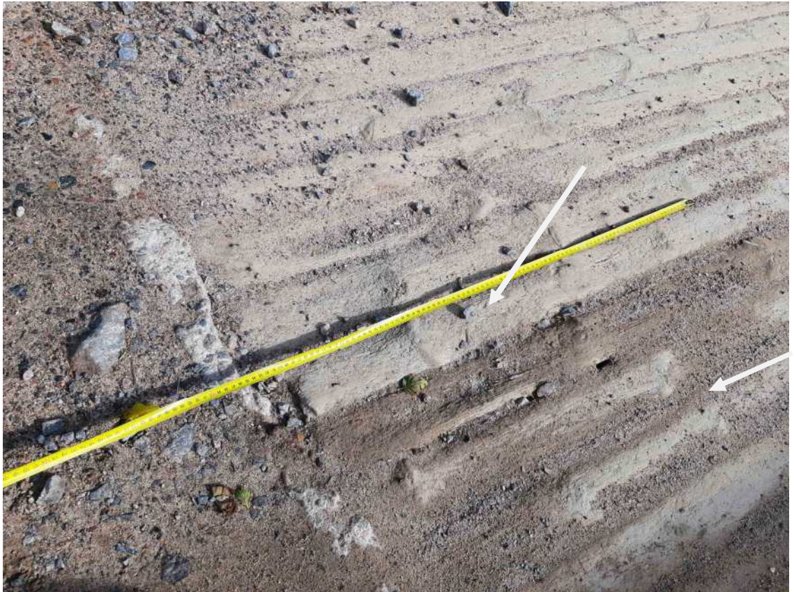
Kuva 9 Kansilankutuksessa on vakavaa kulumaa. Sillan kannella on maaineksia. Myös otsamuurin yläosa on kulunut, kulumaa on paikoin ~20-30 mm otsamuurin yläpinnassa.
