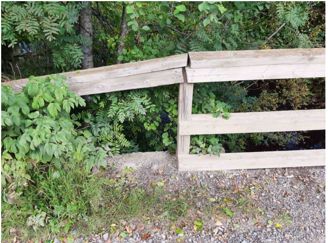
Kuva 11 sillankaiteet ovat huonosti kiinni ja päätyviisteiden kiinnitys on ajan saatossa löystynyt. Kaiteet ovat vakava turvallisuusriski.
