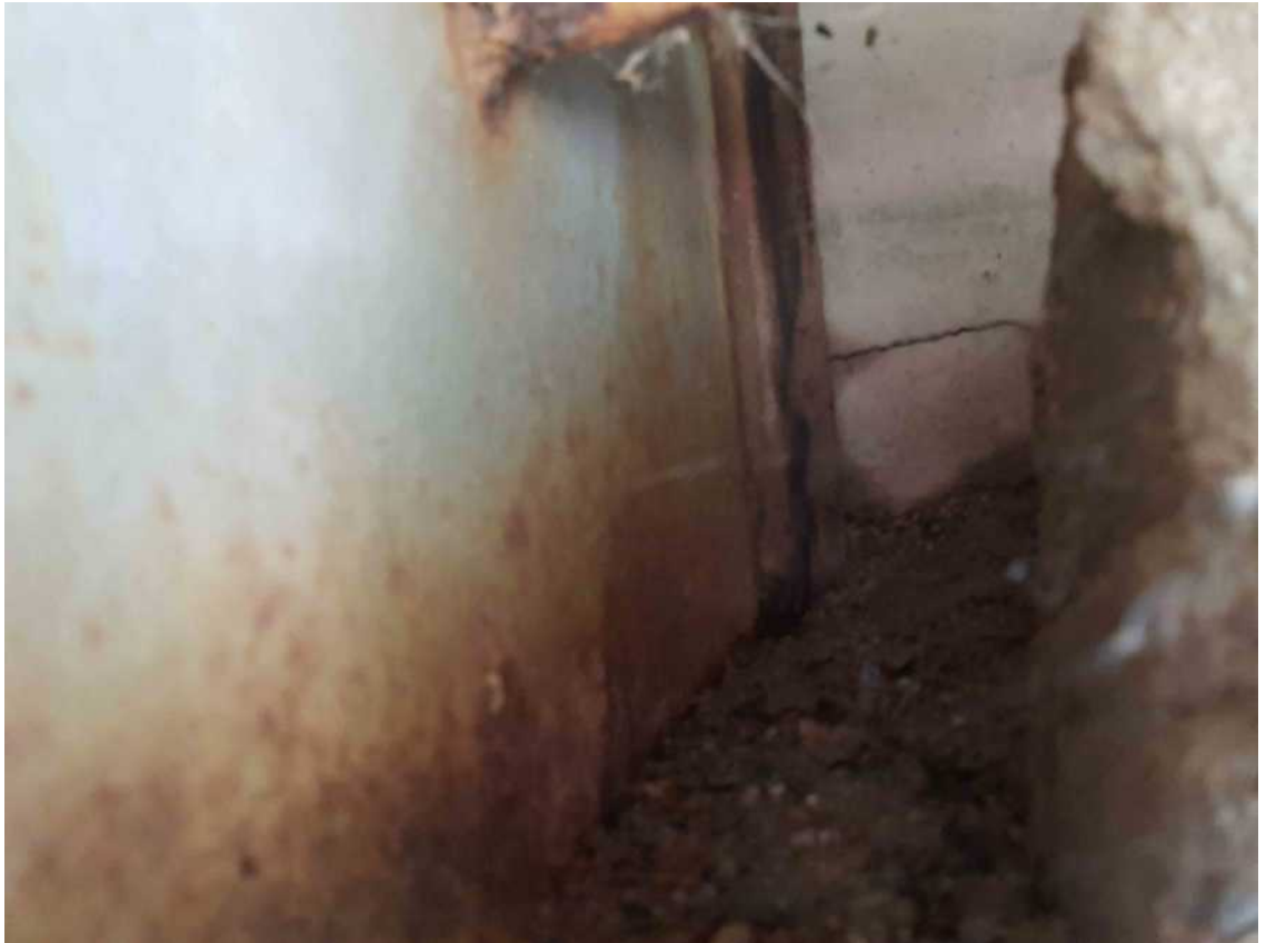
Kuva 13 Maa-aineksia on hieman valunut lakeritasolle liikuntasaumasta.
