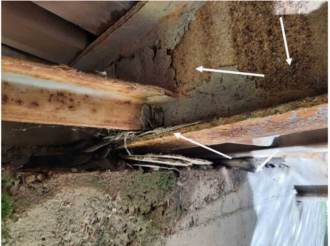
Kuva 6, Sillan laidasta lukien kolmannet palkit ovat todella pahasti ruostuneet, poikkileikkaus ala on pinentynyt paikoin milli luokkaa. ruoste lehteilee palkkien pinnasta voimakkaasti laakeritasojen kohdalla.
