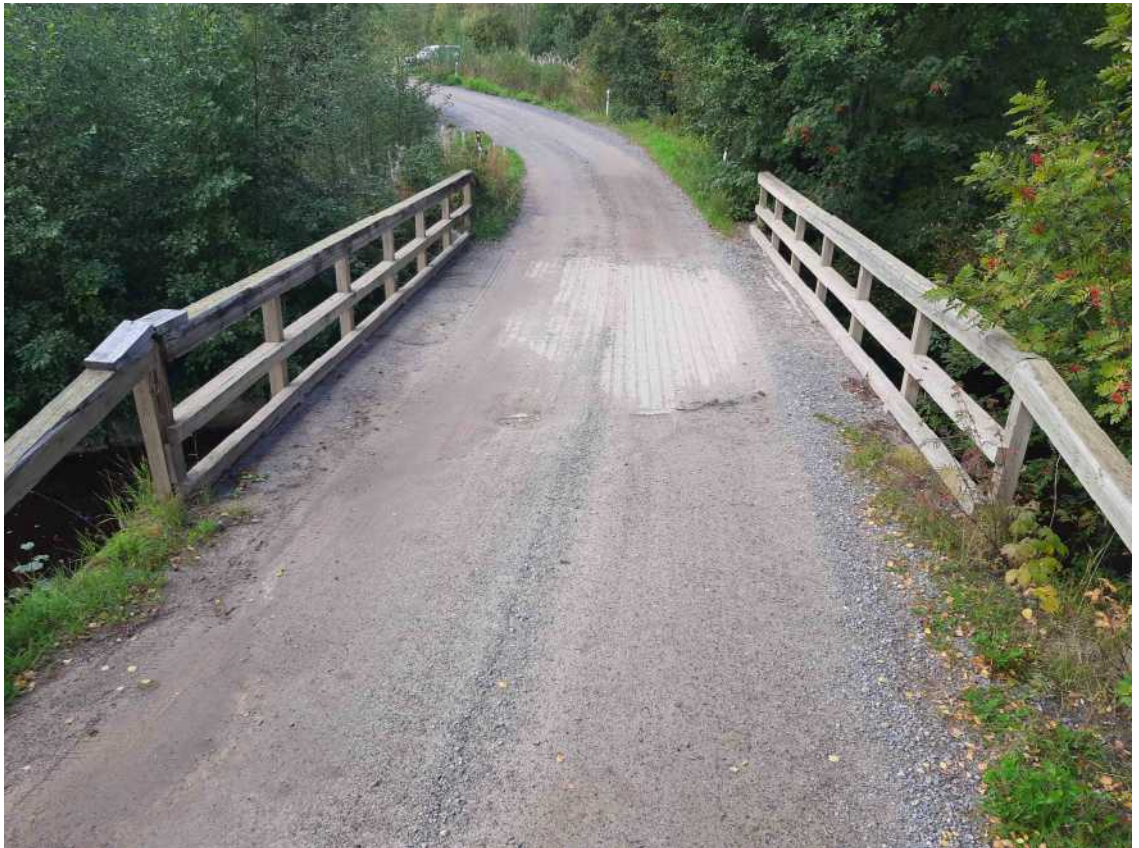
Kuva 16 Tiessä siltapaikalle on tuen 1 ja 2 penkereellä yksittäisiä purkautumia. Pengerkaiteet puuttuvat.
